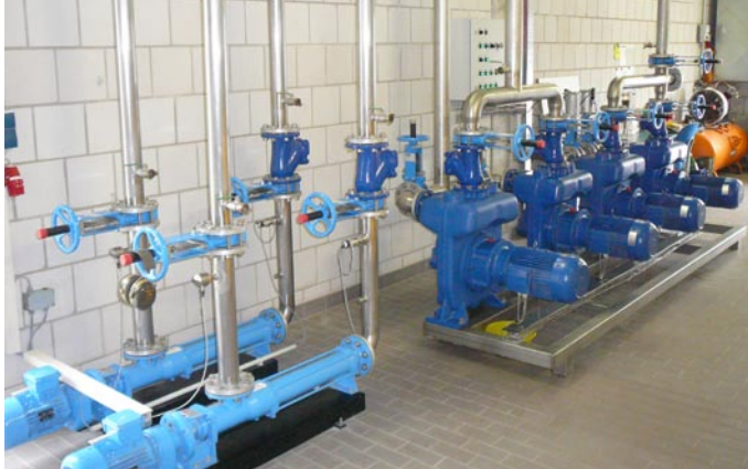
Abb.: Betriebsgebäude SBR-Anlage mit Pumpentechnik
